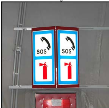
Nødstasjon med nødtelefon og to brannsløkkarar.
