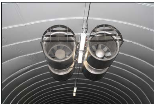
Eksempel på ventilasjon i tunnel
