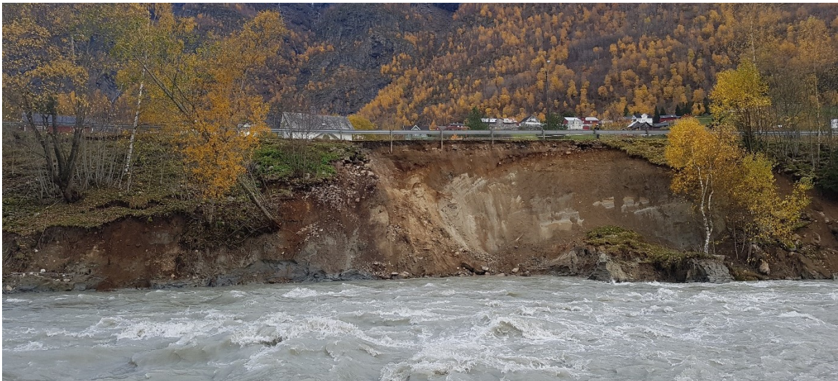
Bilde teke 15/10 ca kl. 12 ved Smiebakken. Her rasa det kontinuerleg utover dagen. Området sperra av politiet. Foto: Svein Jarle Slinde, Statens Vegvesen
