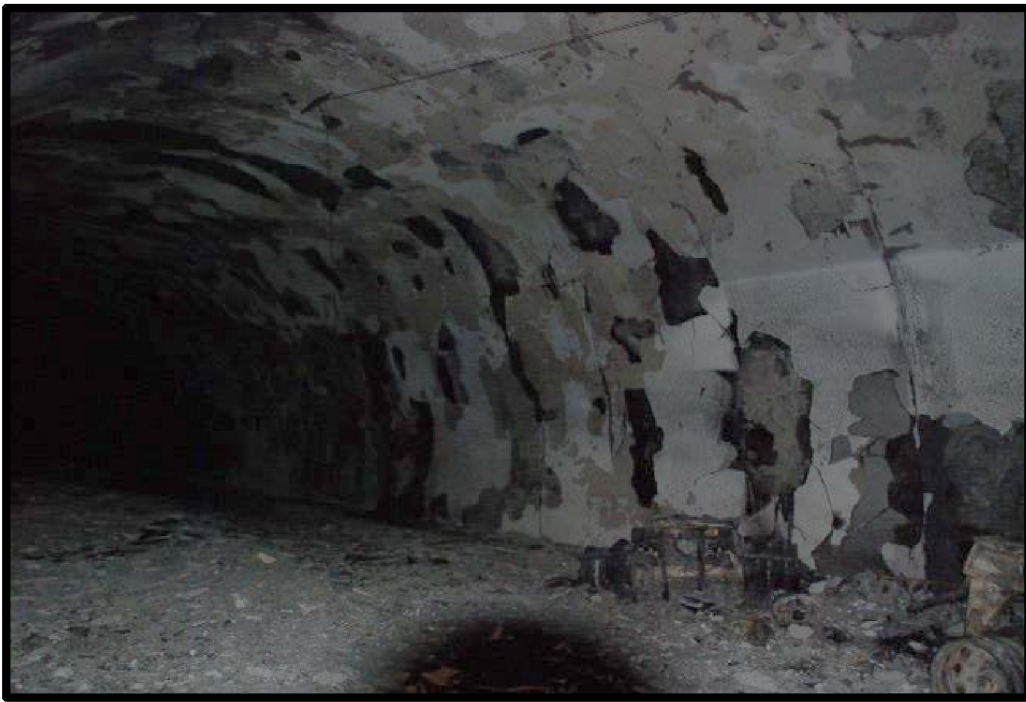
Foto 2 Skade på tunnelen (Røykdykkar)
