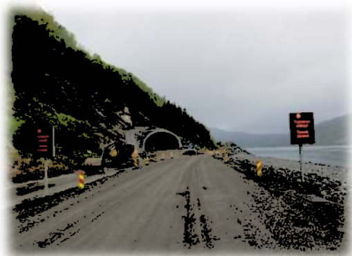
Variabelt skilt til arbeidsvarsling og stenging av tunnel
