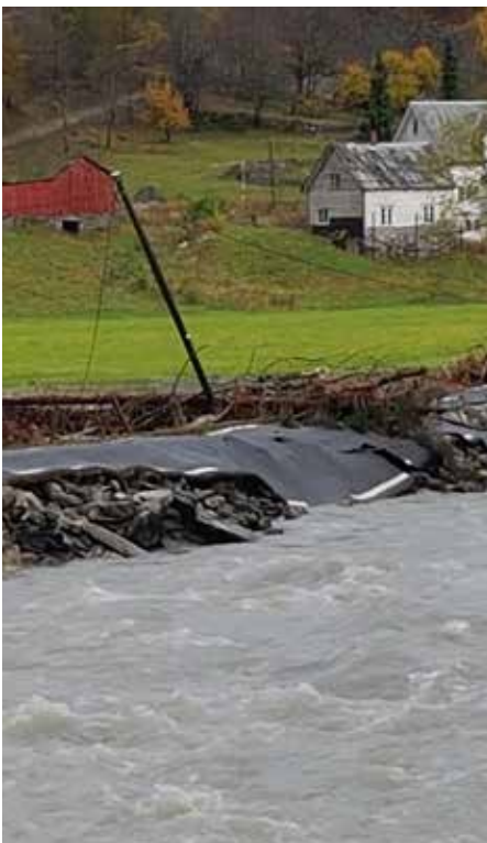
Skadar på veg i Luster kommune som følgje av flaumen i oktober 2018. Foto: Statens vegvesen.
