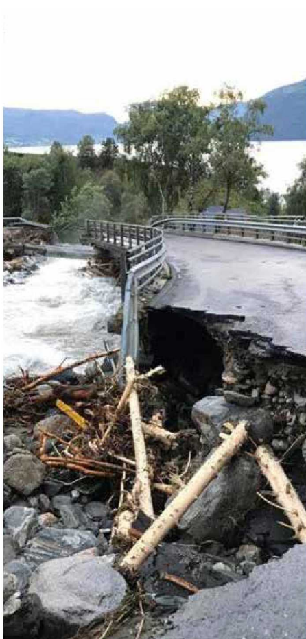
Flaumskader på fv. 60 ned mot Utvik sentrum i juli 2017. Foto Statens vegvesen.
