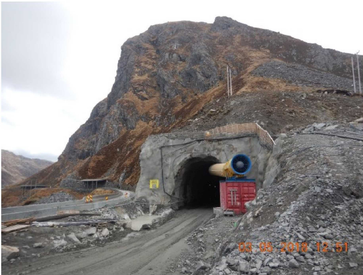
Figur 2 - Påhogg Halsen. Området er sikra med sognemur, men er p lanlagt erstatta med betongmur. Foto: Gro Kjoss Lyng, SVV
