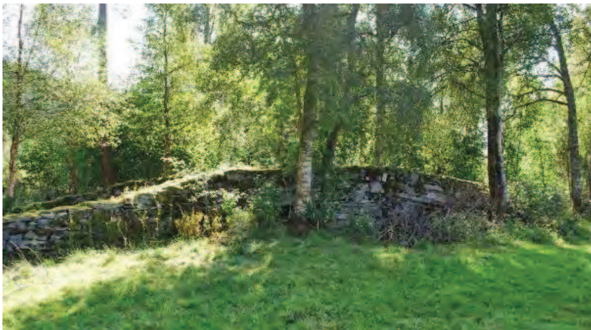
Figur 4.8: Ei av bruene på Sindreøyane. Sidan elva her er lagt om, ligg brua i dag på tørt land. Det veks både tre og mindre vegetasjon både på og tett inn til brua, og også på og ved andre deler av postvegen. Vegetasjonen øydelegg kulturminnet, og må fjernast. Skjøtsel er også viktig for at postvegen i større grad skal kunne brukast som turveg. Foto: Marit Anita Skrede, Statens vegvesen 2017
