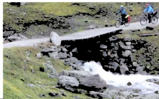
Th: Overbelasta bjelkebru.
