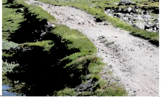
Th: Dårlig stikkrenne og utvasking.
