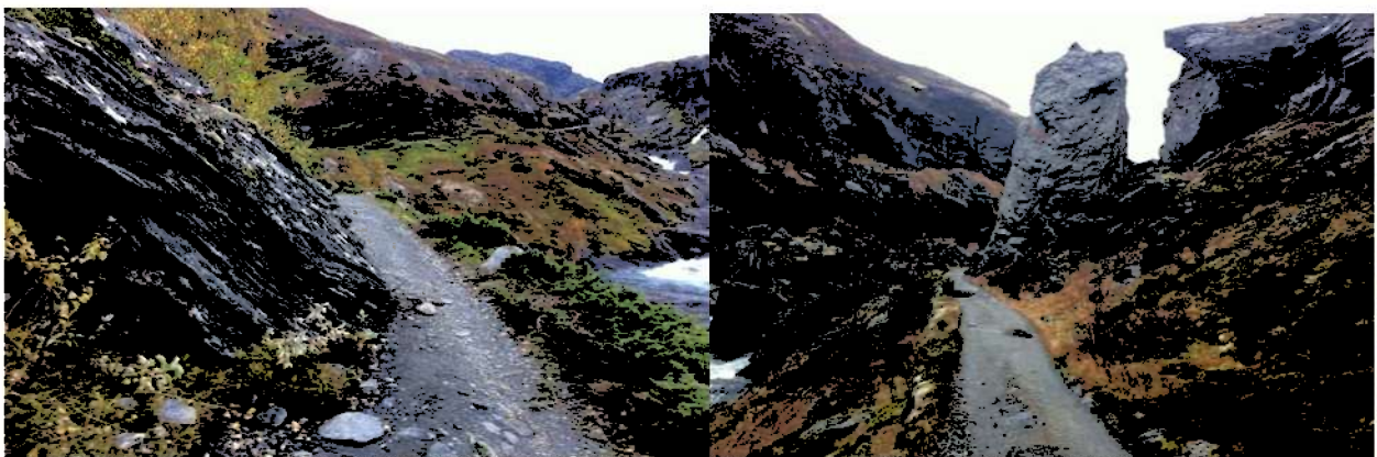
Tv: Klevagjelet. Tv. blokk på sig ned og inn i vegen. Th.: store blokker pressar på.
