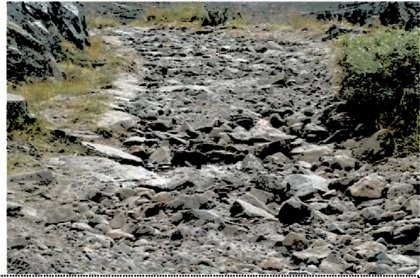
Th: Resultat av manglande gröft og stikkrenne.
