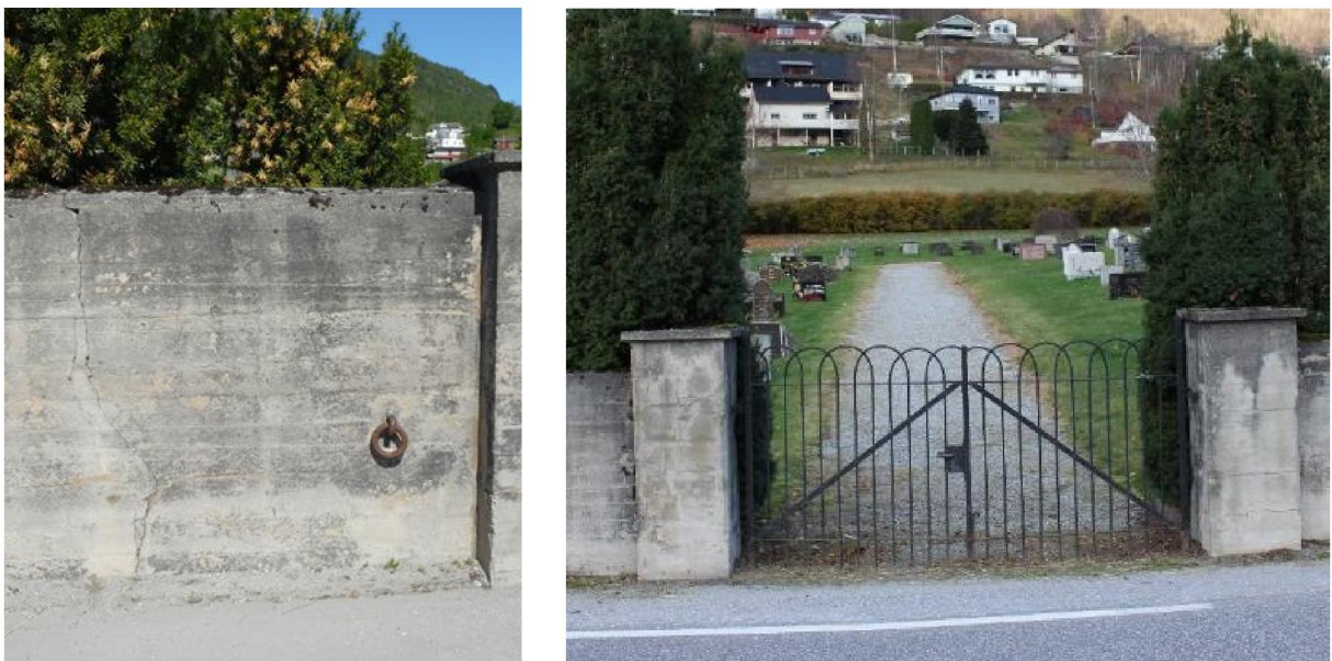
Figur 12: Foto viser betongmur med sprekk, hesting og ein av gravplassportane. Foto: Hilde Ruud /Torunn Løne Vinje, Luster kommune
