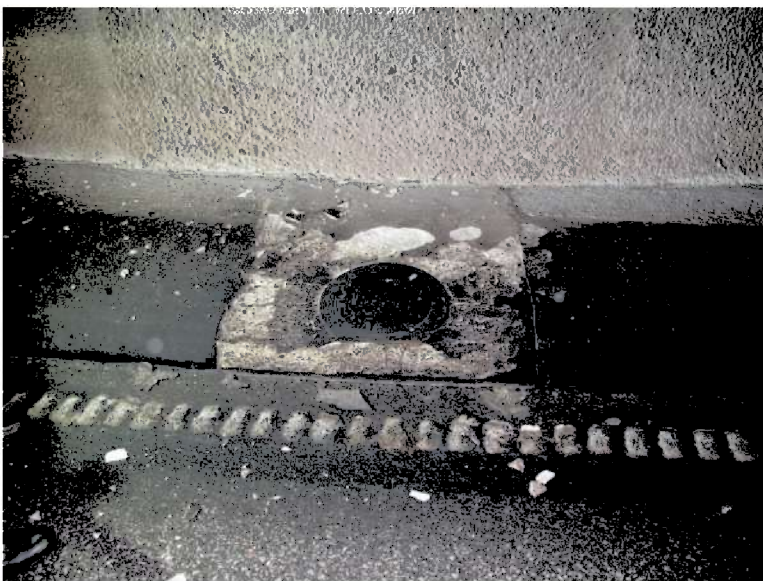
Figur 22 En inspektionsslucka som hör till bergvattensystemet 175 m från pumphuset.
