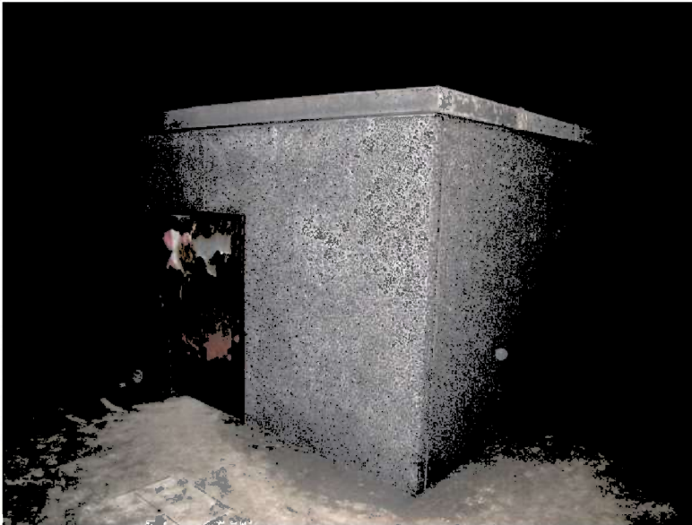
Figur 21 Våldigt speciella brandskador på dörren in till pumphuset som ligger rakt ovanför slambassängen. Bortom och bredvid pumphuset finns ett galler som man kan promenera på. Nedanför det finns slam- och vattenbassängen. Det fanns tydliga tecken på att det har brunnit nere i slambassängen.
