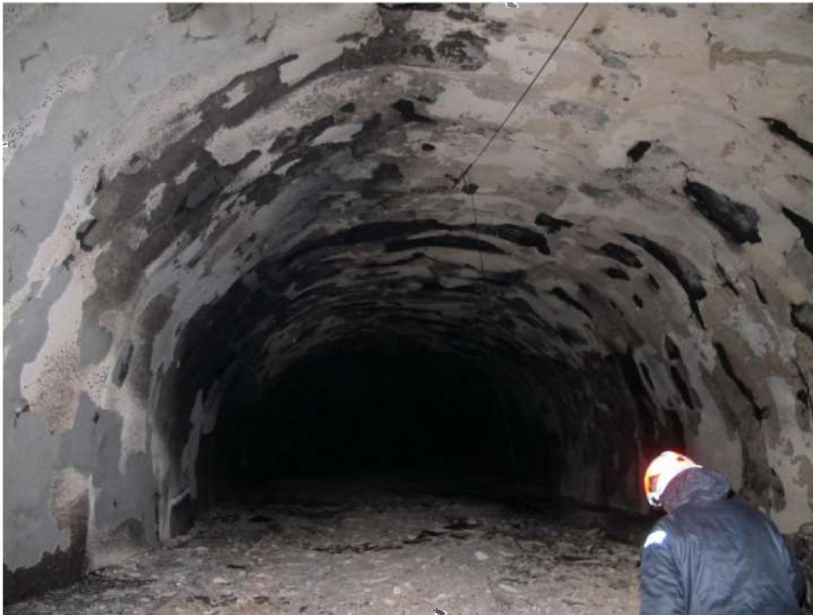
Figur 17 Skador på sprutbetongen strax ovanför släpet.
