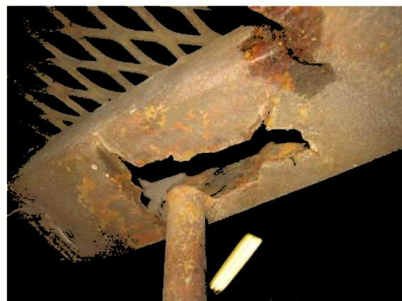
Figur 14: Rustskader i høyre dragstang. Foto: Statens vegvesen
