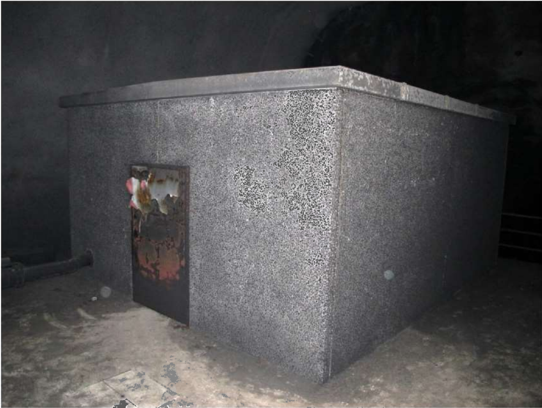
Figur 31: Pumpestasjonen ved bunnen av tunnelen med brann- og sotskader på overflatene. Foto: SHT
