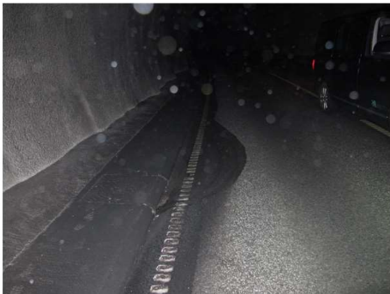
Figur 20 Vid brunn nr 3 finns en avvikelse på hur bensinen har runnit ner längs vägbanan. Den buktar ut och det ser ut som bensin har flödat ut ifrån brunnen.
