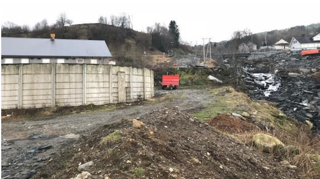
Bildet er teke oppover mot brekka. Røyret vil kome nedover mellom grana og høgspenmasta i himmelsjø og vidare mellom elva og jøsselsiloen. Herifrå har NVE laga ny anleggsveg ned mot stasjonstomta.
