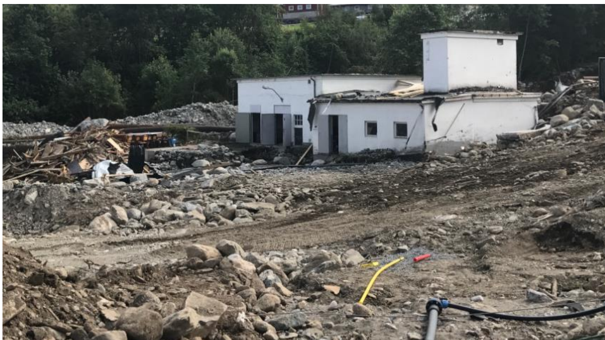
‘Gamlestasjonen’ med alt utstyr vart totalskada under flaumen som gikk over taket på heile bygninga!
