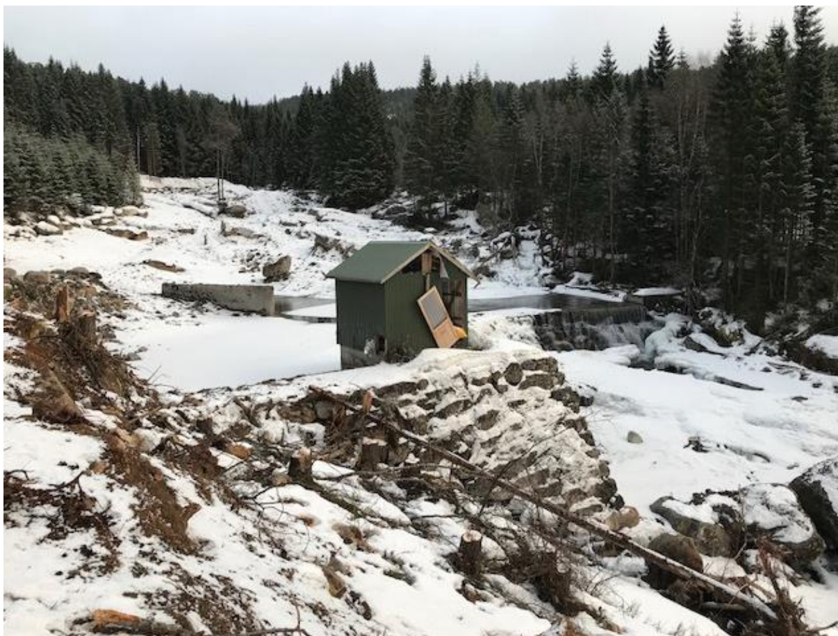
Inntaket etter at NVE har reinska det for om lag 10.000 m 3 med stein og grus.
